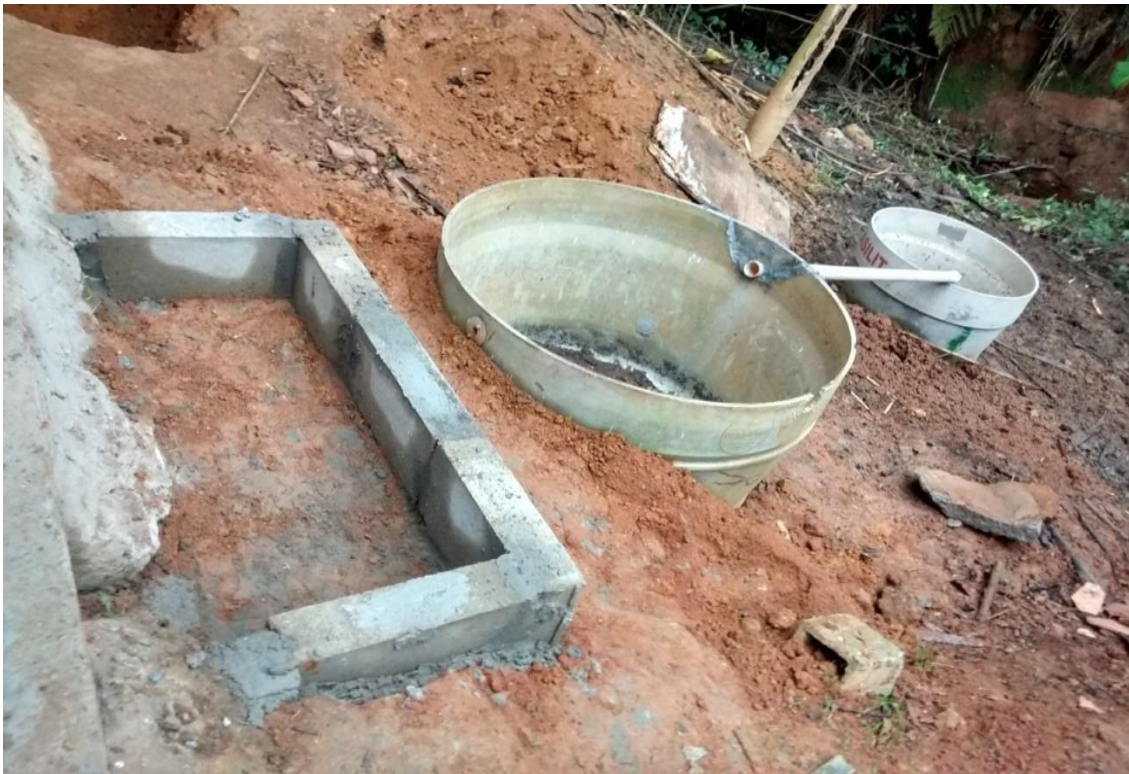
FIGURA 2 – Foto da Construção do biodigestor, PPJ dos estudantes do 3º ano de 2016
