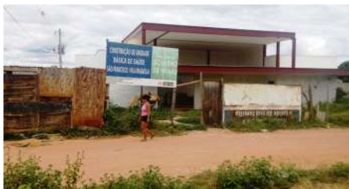
Figura 02: Construção UBS paralisada.
