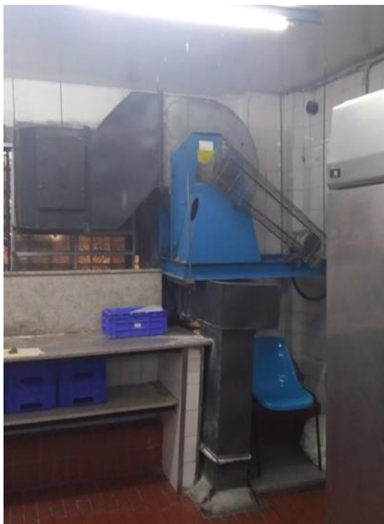
Figura 35 – Exaustor instalado na área de produção.
