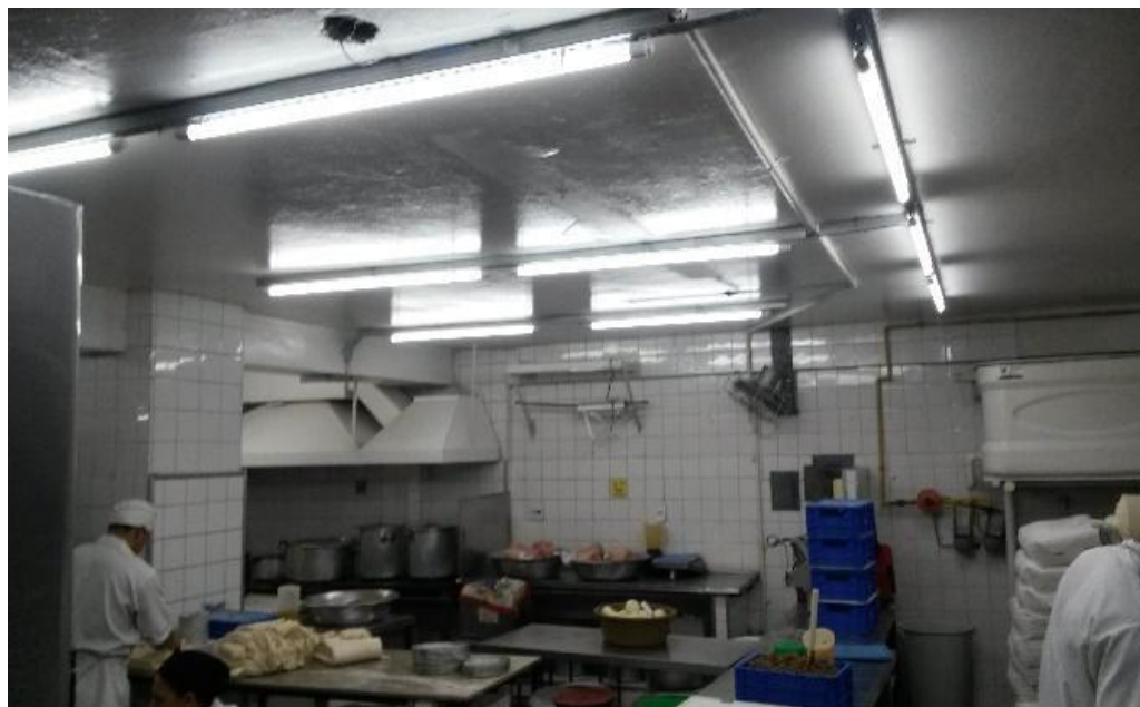
Figura 38 – Iluminação após a adequação.
